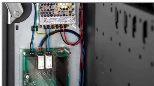
Verkabelung nach VDE-Richtlinien
